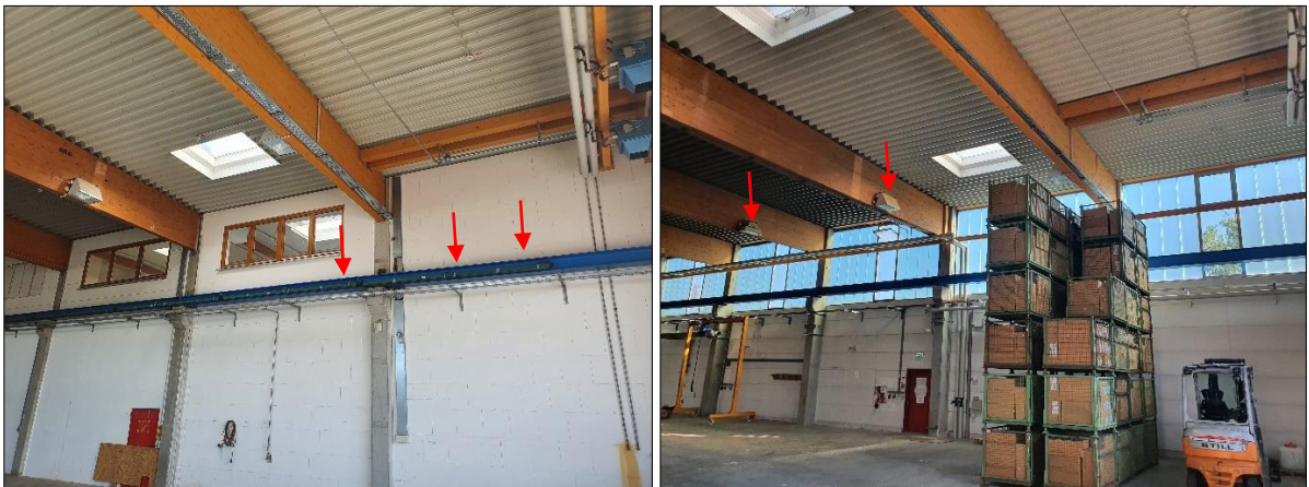
Abbildung 6: Potenzielle Nistplätze für störungsresistente Frei- und Gebäudebrüter oberhalb von Leitungen (linkes Bild, rote Pfeile) und Beleuchtungen (rechtes Bild, rote Pfeile).
