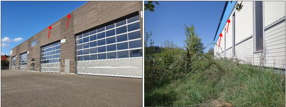
Abbildung 5: Attika an der Westseite der Halle (linkes Bild, rote Pfeile) und Wellblech mit darunterliegender Holzverkleidung mit Quartierpotenzial für Fledermäuse (rechtes Bild, rote Pfeile).
